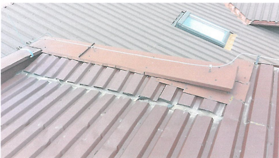
Fot. Nr 3 – Widok dachu - błędne ułożenie blachy – jako „pozytyw
